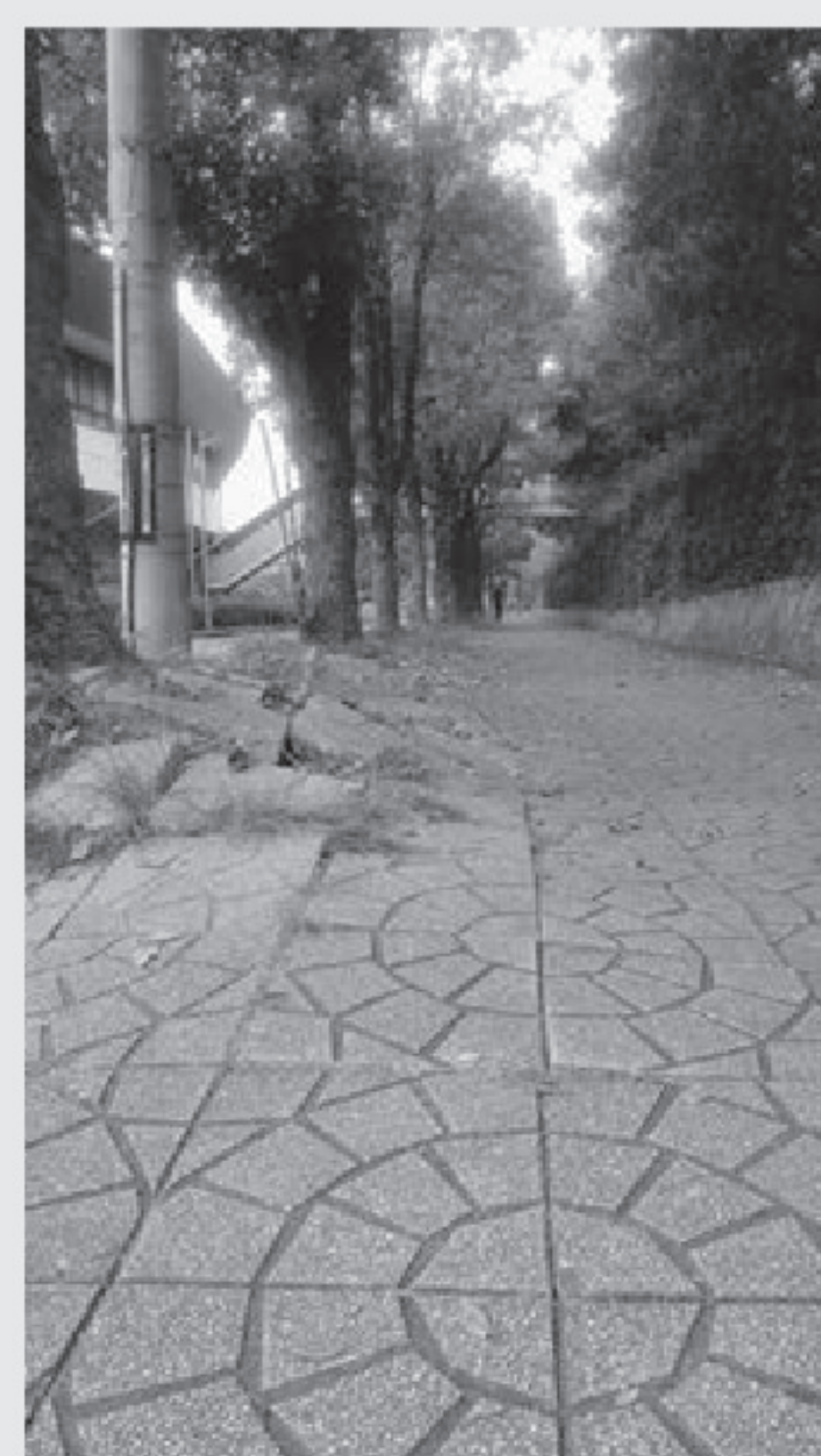
根が地面を押し上げている危ない歩道
