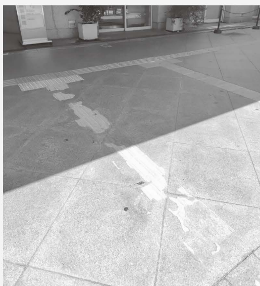
JR奈良駅西口の損傷により役に立っていない点字ブロック
